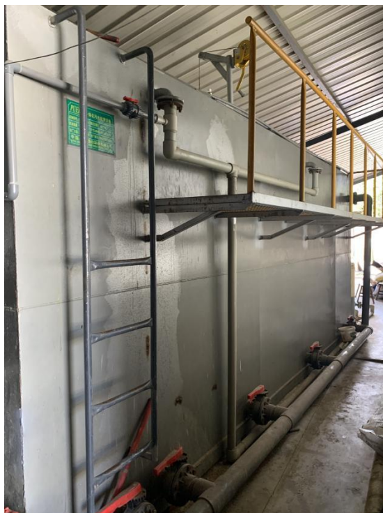
图 5-4 废水处理设施图
